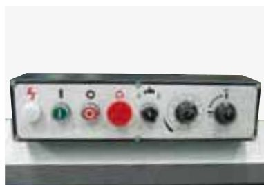
Unidad central de control
